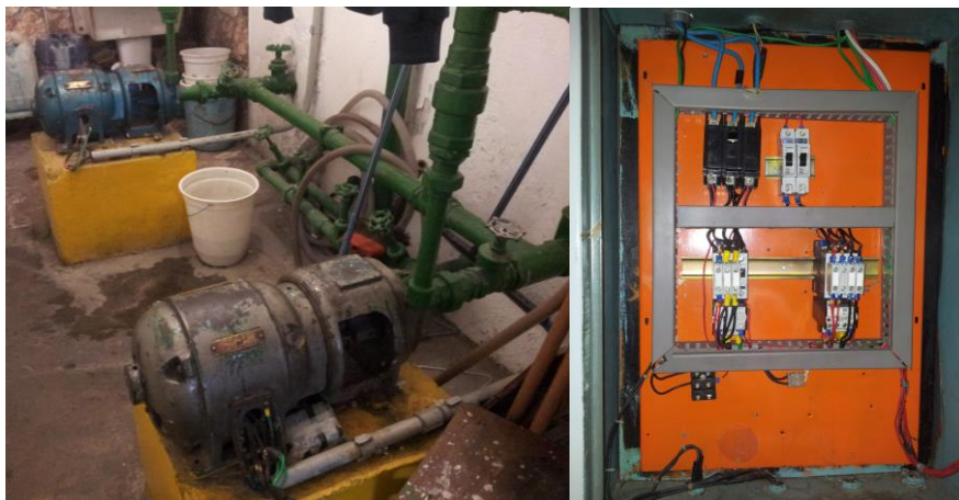
Figura 8 - Sistema de abastecimento de água do Bloco 1
