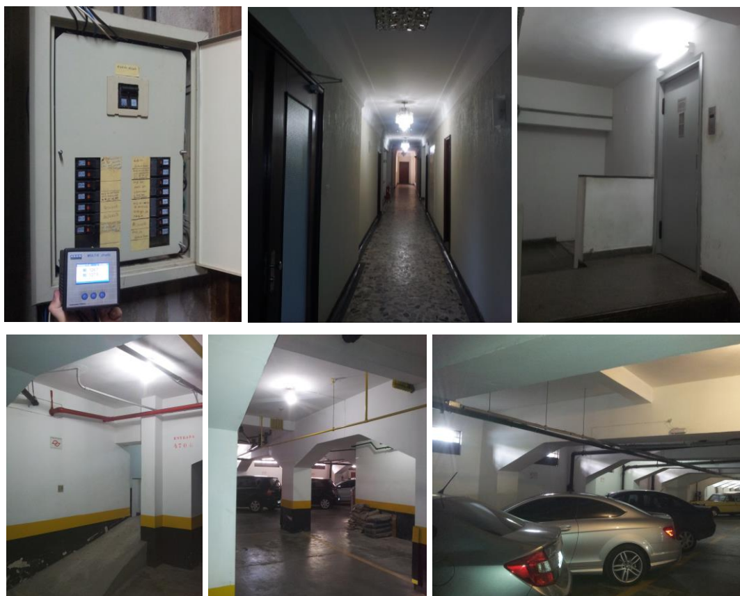
Figura 7 - Sistema de iluminação do bloco 1 e garagem
